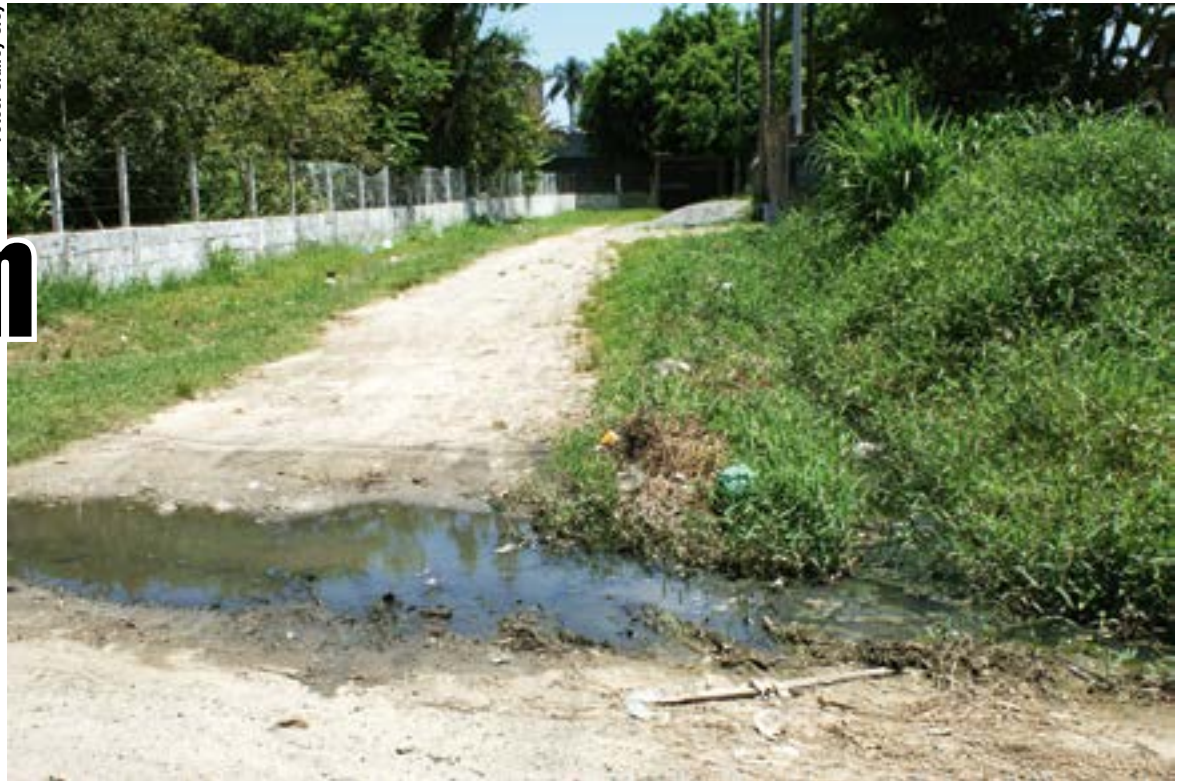
Esta vala é na Rua cinco, onde passa o ônibus, como está obstruída pelo mato, transborda e o esgoto corre a céu aberto. Além do mau cheiro, a vala traz baratas, ratos e cobras.
